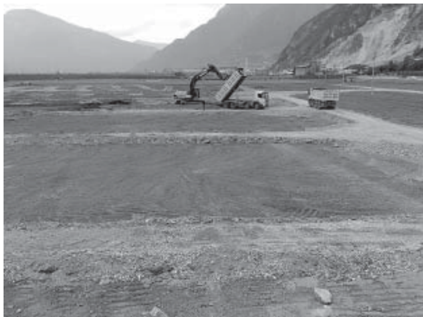
Ruspe e camion al lavoro nell'area sulla quale sorgerà la nuova S.T.F.
